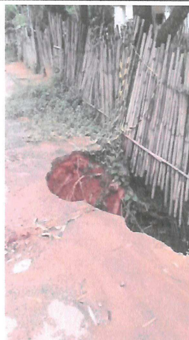
Foto 02: Buraco resultante do rompimento da drenagem
