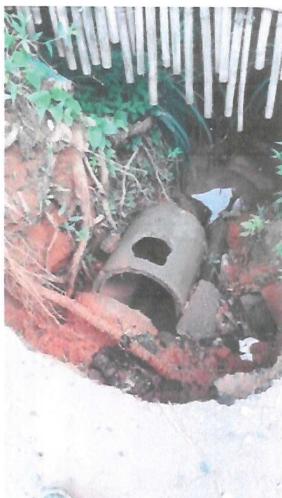
Foto 03: Rede Drenagem Pluvial danificada
