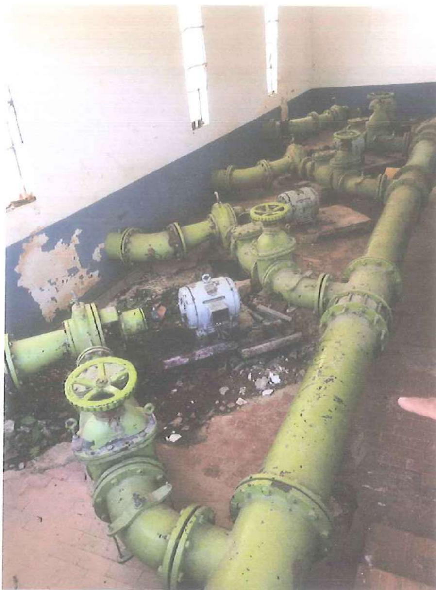
interior da edificação com abatimento de piso
